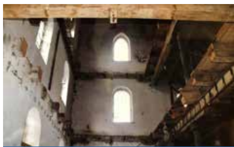
Chátrající zdi a rozebraný interiér. Tak vypadá parní mlýn dnes.
